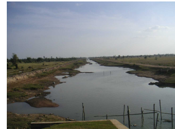
兩岸の田面標高と比して極めて水位が低い。通常ポンプアップし灌漑を行っているとのことである。また水路断面も崩壊している。
