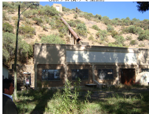
発電所の全景。水圧鉄管は老朽化しており発電所の取り付け部で破損
