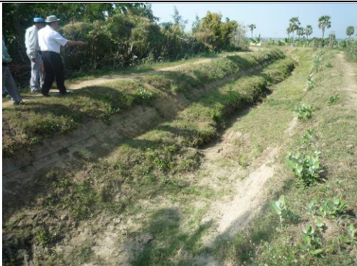
⑮ 水路 1 (Chit Thu ポンプ場) : メインポンプから 100m 程度離れた地点の水路。土砂が堆積し、水路に堆積している。
