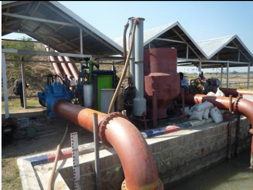
⑨ 籾殻発電機 (Yakyi Pauk ポンプ場) : 3 機の電力ポンプが稼働、1 機は籾殻を燃料とするバイオマス発電機を併設。
