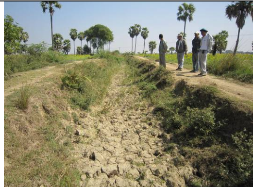
⑯ 水路 2 (Chit Thu ポンプ場) : 末端側の水路。維持・管理が行き届かなく、配水に支障をきたしている。
