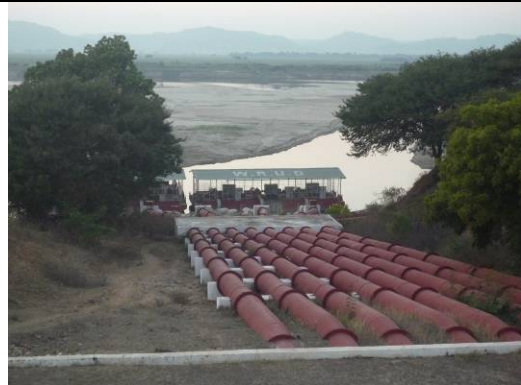
⑫ メインポンプ (Lawkananda ポンプ場) : 水源はエーヤワディ川、取水は浮船式である。
